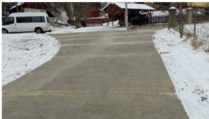
Wykonanie części drogi betonowej wraz z przebudową skrzyżowania oraz przedłużeniem przepustu ul. Leśna
